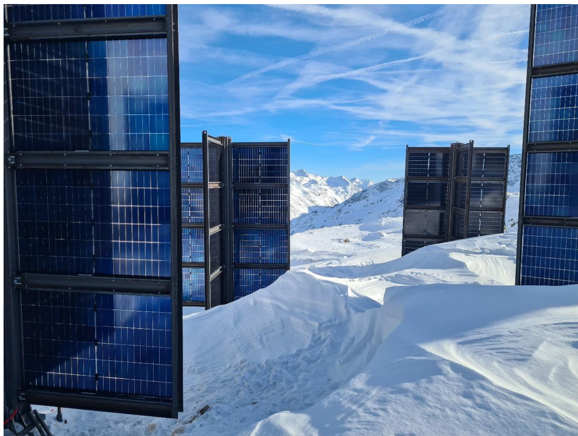
Installation solaire Helioplant Sölden Autriche depuis 2023
